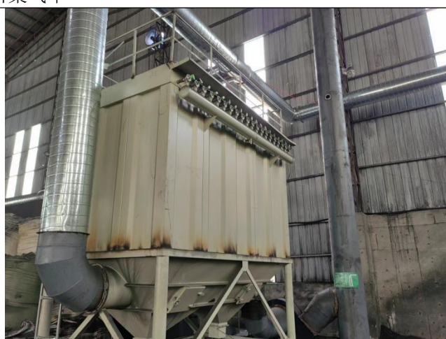
破碎、筛分、进料布袋除尘器
